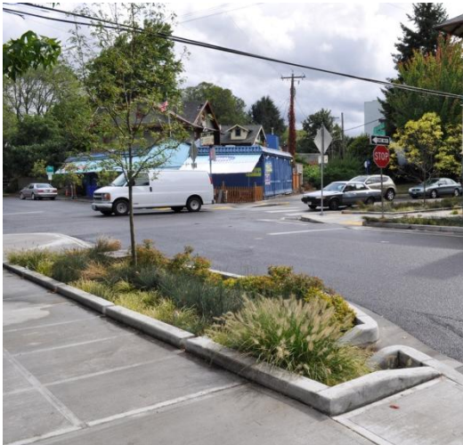
Figure 21 : Noue de biorétention en bordure de rue, Portland, USA. Source : D.Dagenais, CPEUM
